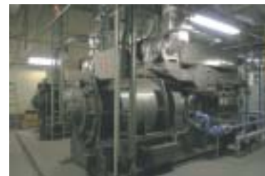
コージェネレーションシステム（茨城工場）
